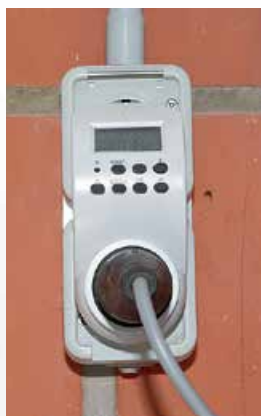
Damit das Rührwerk nur vier Mal am Tag für jeweils fünf Minuten in Betrieb geht, installierte Mucker eine Zeitschaltuhr.
